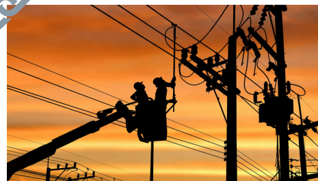
Un amortisseur électricité pour les entreprises et les collectivités dès 2023
